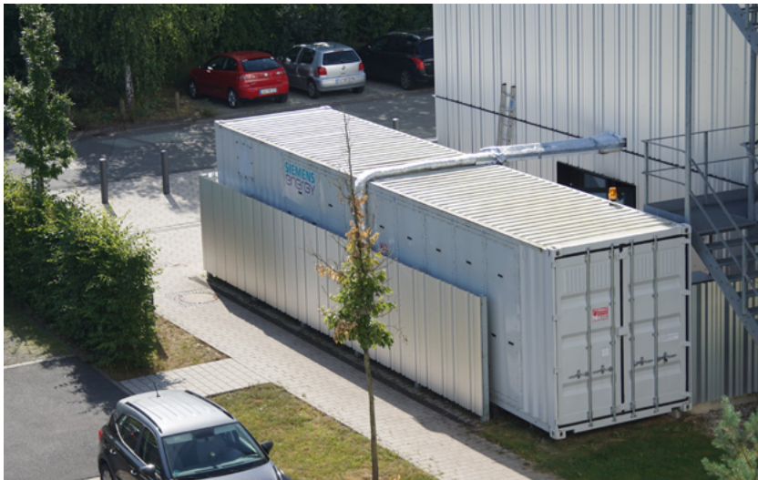
Abb. 13: Das Bild zeigt den 40 ft Container mit dem Gleichrichter, Drei-Level-Antriebsumrichter, einem Halbleiter-Leistungsschalter und einer Kühleinheit vor dem Mittelspannungslabor des Instituts IISB der FhG (MV DC grid for ships test setups for Siemens Energy at Fraunhofer IISB medium voltage lab, Erlangen)
