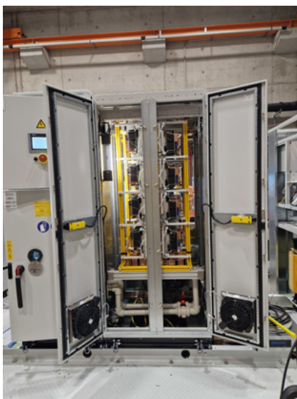
Abb. 6: Finaler Aufbau des DCDC-Wandlers innerhalb des Testsystems
